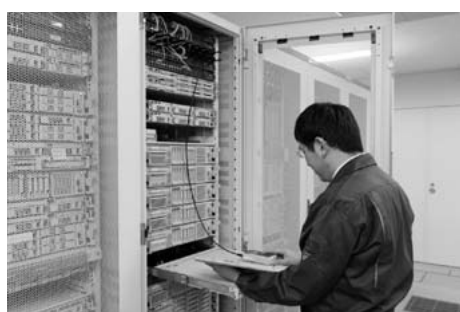
システム保守点検作業
