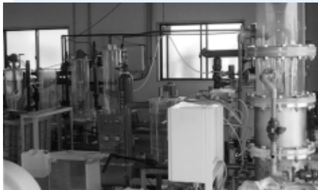
難分解性排水処理装置
