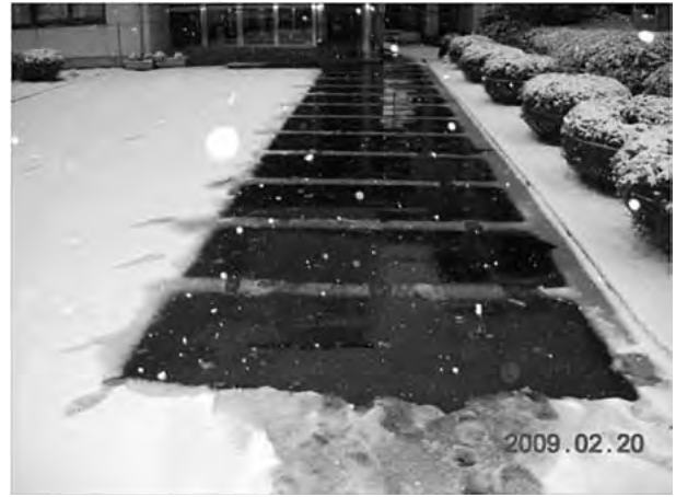
図8 八戸でのロードヒーティング使用例
