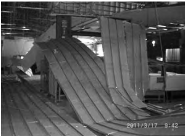
若柳工場 震災後の様子
