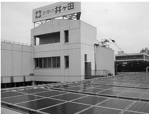
屋上に設置された太陽光発電設備
