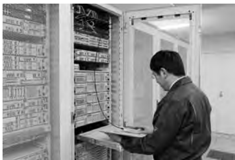
システム保守点検作業
