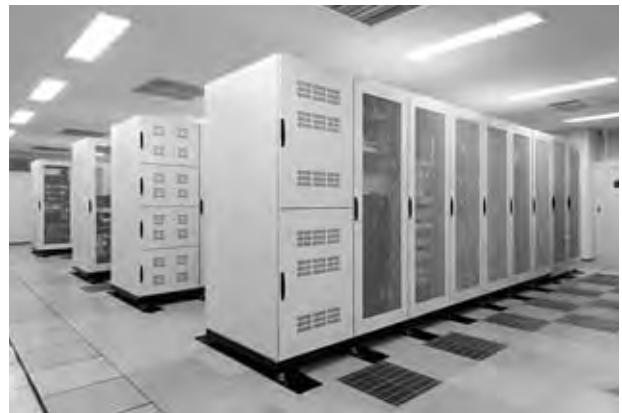
「iDC」内のサーバ
